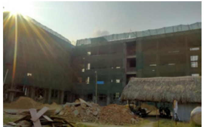
Rào chắn che công trình đảm bảo an toàn lao động và môi trường xung quanh khu vực xây dựng
